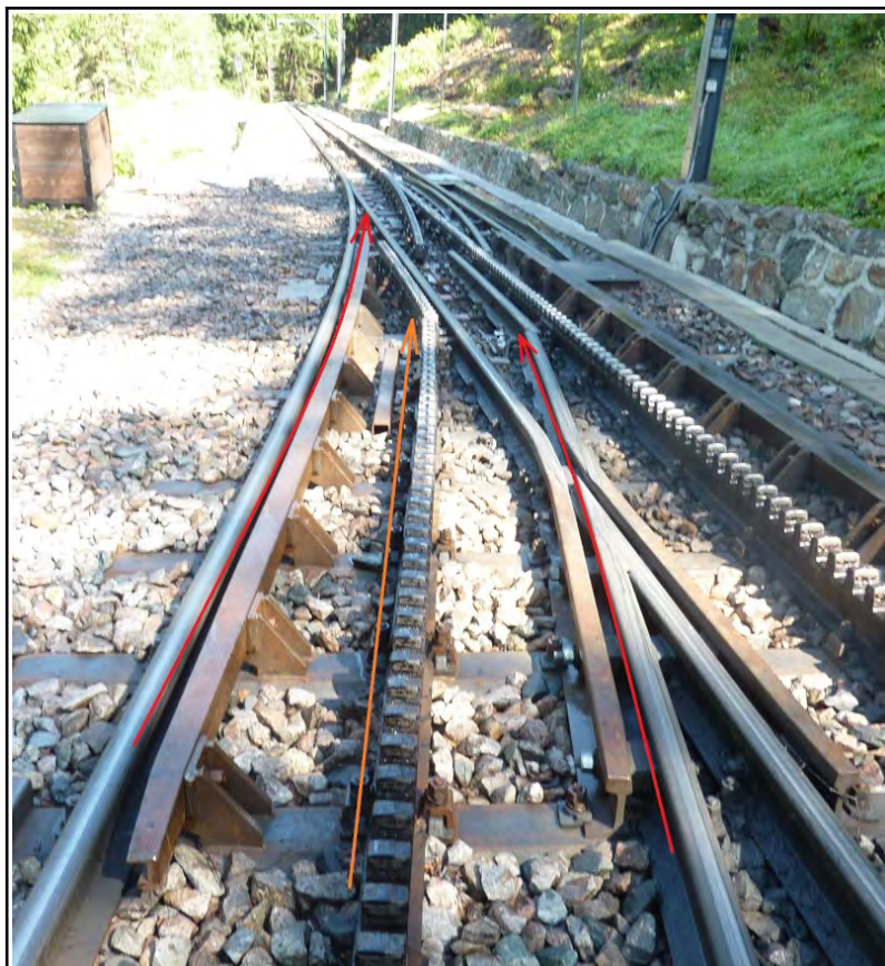
Figure 31 : Position de l'aiguillage des Planards aval, dans la position présentée au conducteur de l'A46 le 11 août 2019
