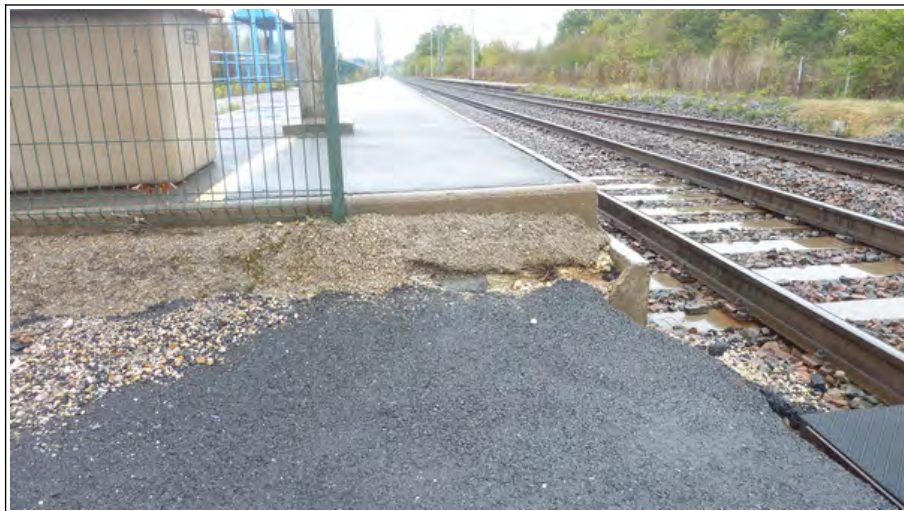
Vue 16 : le passage entre le quai de la voie 2 et le PN112
