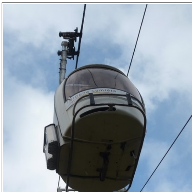
Figure 41 : visuel sur les pinces de la cabine depuis le sol, au pied du P1 (photo prise lors des essais en novembre 2018)
