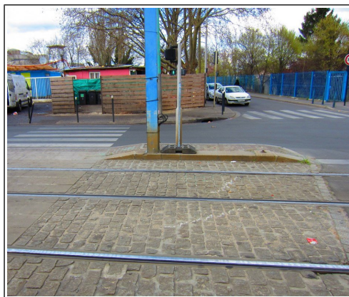
Fig. 20 : le poteau support de LAC impliqué dans l'accident
