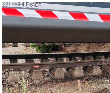
Figure 3 : Affaissement sous la voiture n°1 du TGV 8517, le 20/05/2025 (photo SNCF Réseau)
