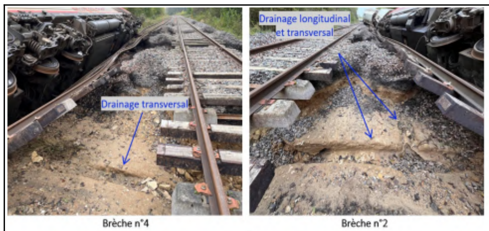
Figure 27 : Vue des tranchées transversales visibles dans les brèches. Source SNCF
