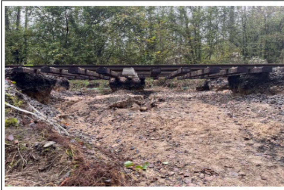
Figure 25 : Vue générale d'une brèche Photo SNCF
