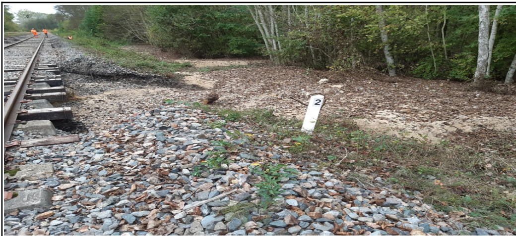
Figure 18 : Ravinement de la plateforme Photo BEA-TT
