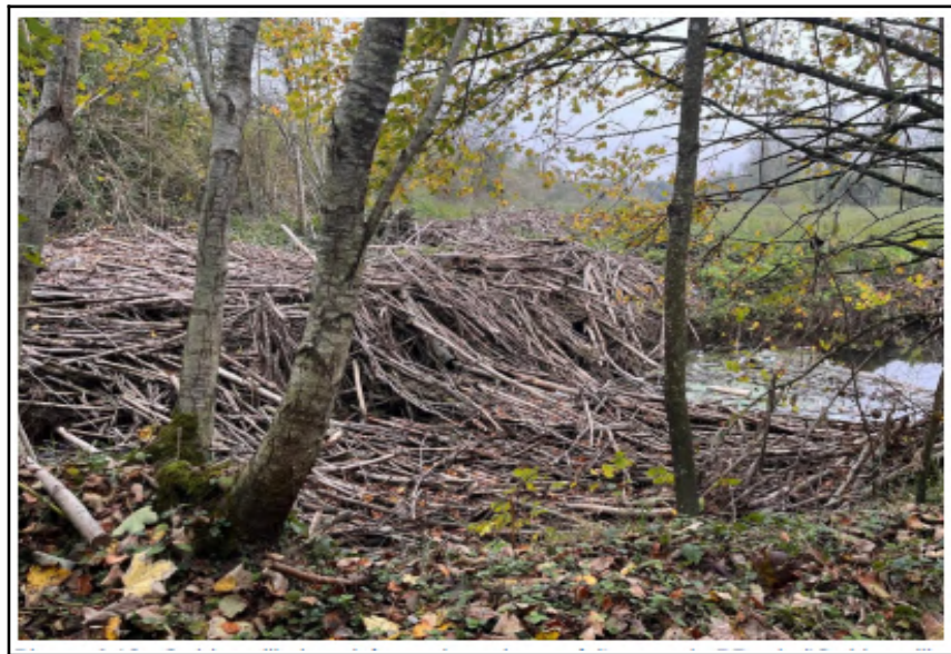
Figure 30 : Vue de l'Ordrimouille bouchée par des branchages à l'amont du PRA de l'Ordrimouille PK 101,659 Source SNCF
