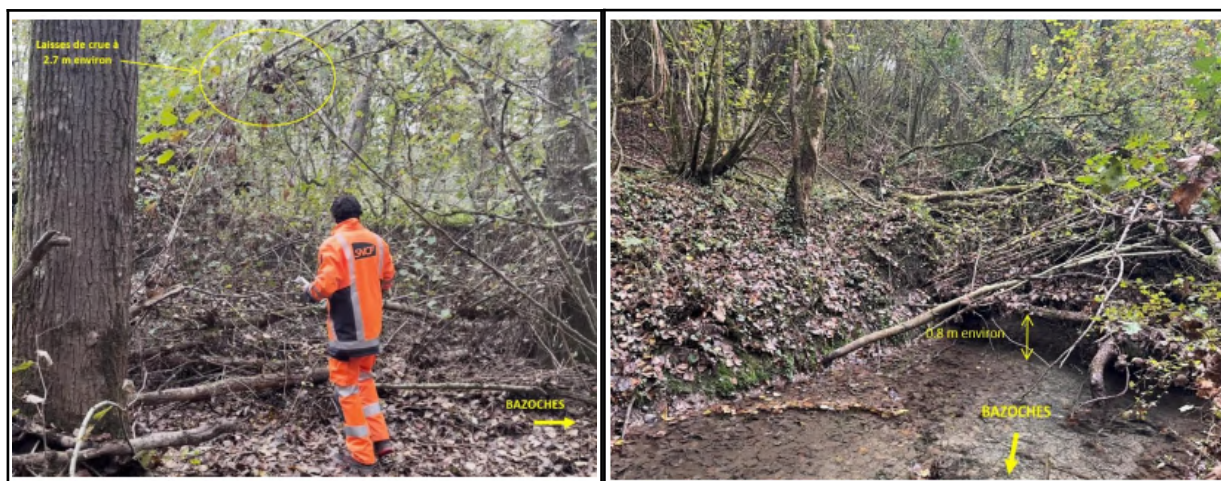
Figure 28 : Vue des embâcles bouchant le ru « fausse rivière » PK 101,100 côté v2 et les laisses de crues coté droit PK 101,100 Source SNCF
