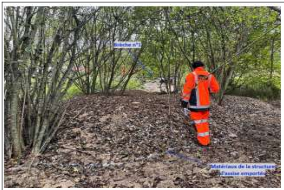
Figure 26 : Vue des matériaux emportés en dehors de la plateforme Photo SNCF
