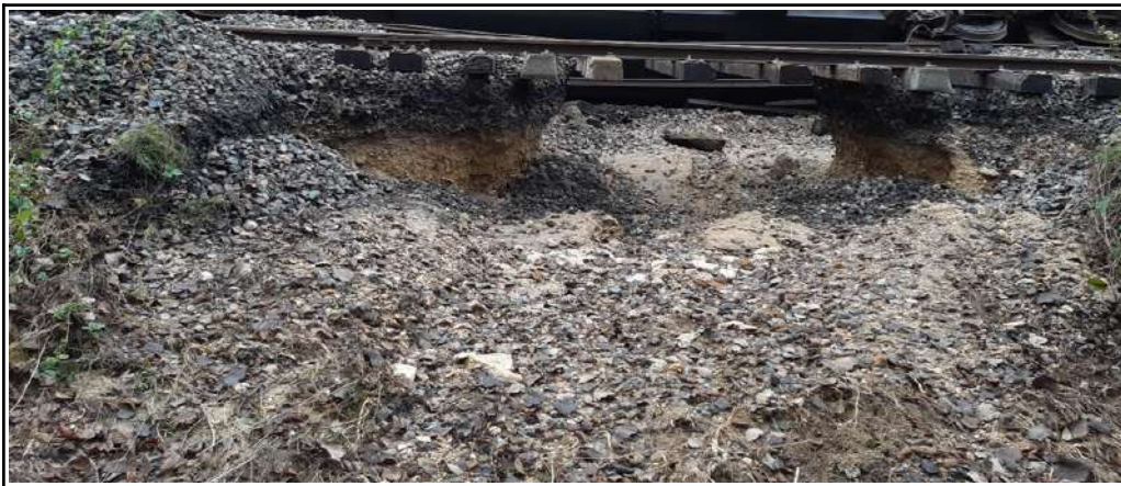
Figure 17 : Dégâts de la plateforme avec brèches Photo BEA-TT
