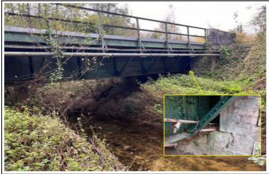
Figure 29 : Vue des laisses de crues côté V2 droit du PRA sur l'Ordrimouille PK 101,659 Source SNCF
