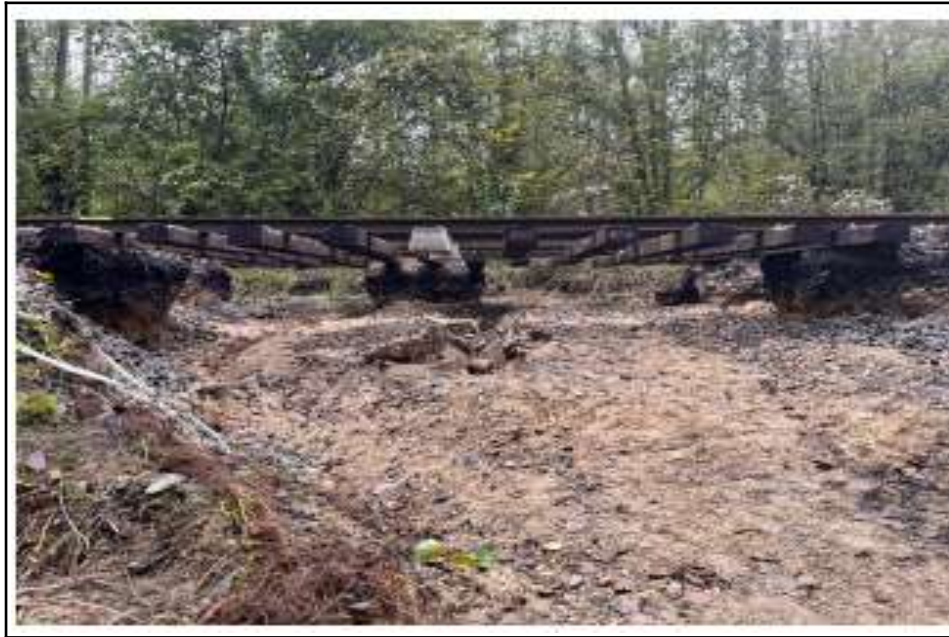
Figure 25 : Vue générale d'une brèche Photo SNCF
