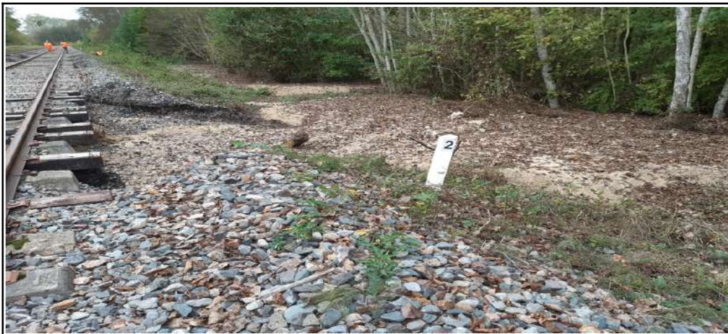
Figure 18 : Ravinement de la plateforme Photo BEA-TT
