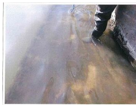
Figure 15 : Vue du renfort sous l'eau (source : CD 60, visite sub. du 03/04/2018)
