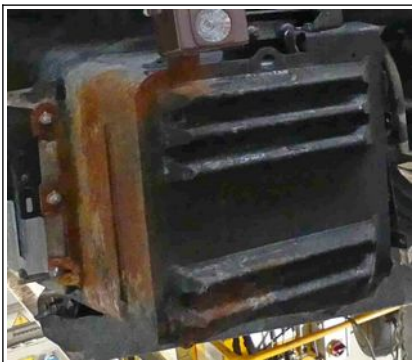
Dégâts sur les absorbeurs
