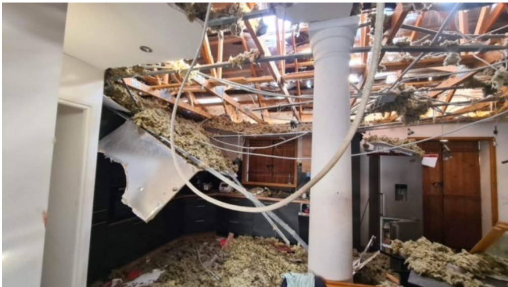
Figure 11 : Intérieur d'une maison détruite (Photo gendarmerie nationale)
