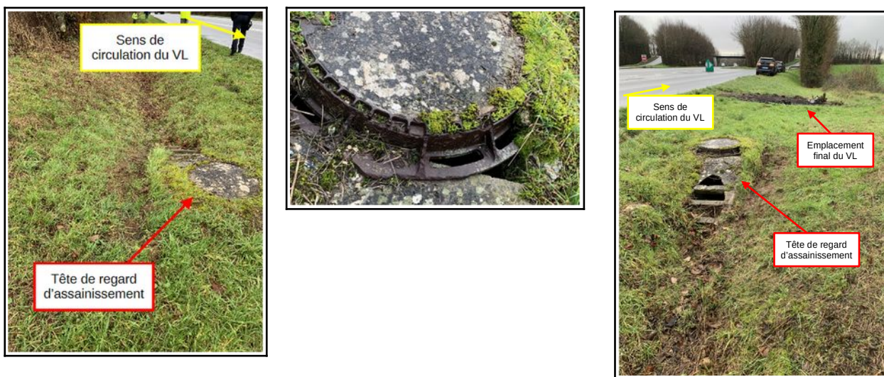
Figure 6 : Visualisation du fossé et des équipements de gestion des eaux (photos BEA-TT)
