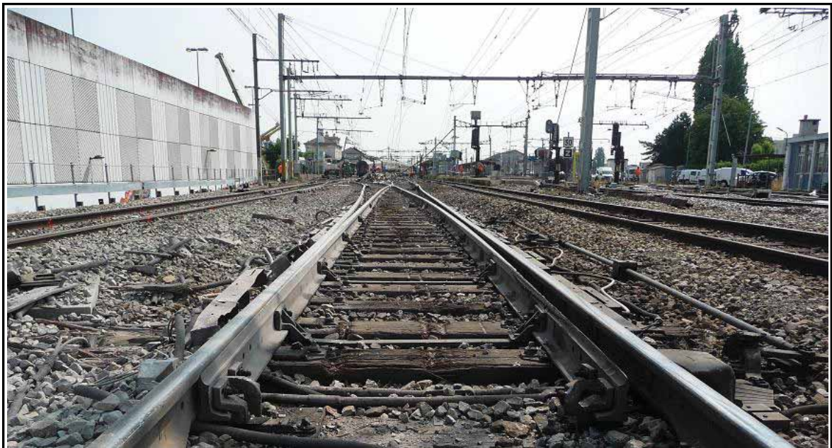
Figure 28 : Vue du branchement simple 21 et des traces de boudins sur les traverses
