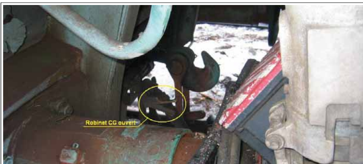
Figure 5 : Vue de la traverse arrière du wagon accidenté
