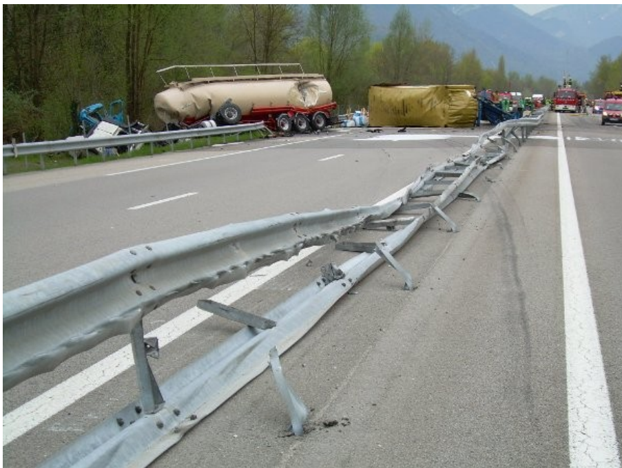
Fig. 10 : Glissière centrale, vue dans le sens de son franchissement par l'ensemble routier porte-conteneur
