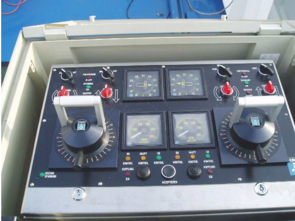
Aileron tribord Platine de commande des propulseurs après les transformations faites à la suite de l'accident
