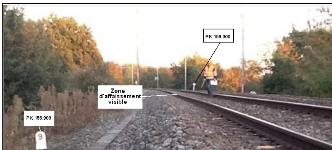
Figure 17 : Vue de la voie 1 dans la zone du déraillement
