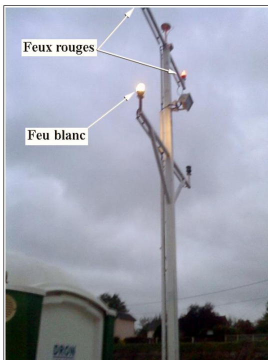
Figure 12 : Mât portant les feux de signalisation du ponton ANGLORE
