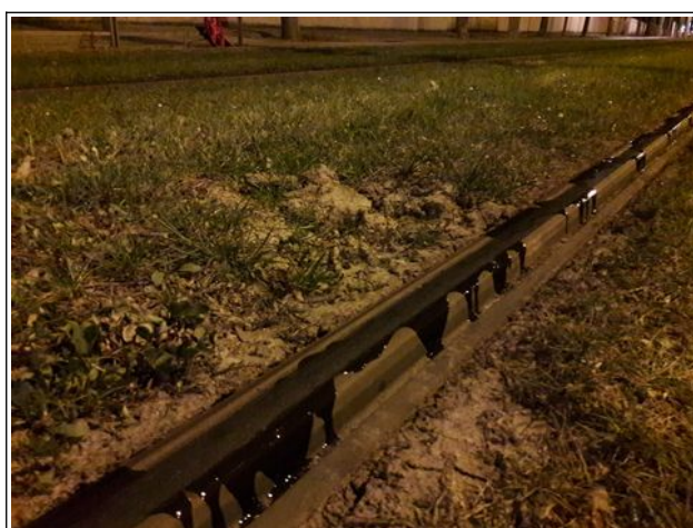
Figure 57 - État du rail graissé (photo BEA-TT)
