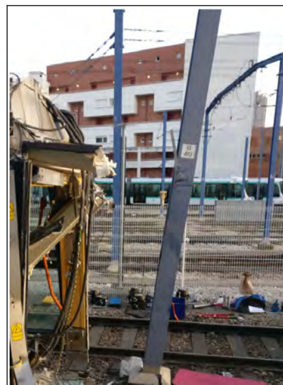
Figure 30 : poteau LAC impacté lors de la collision
