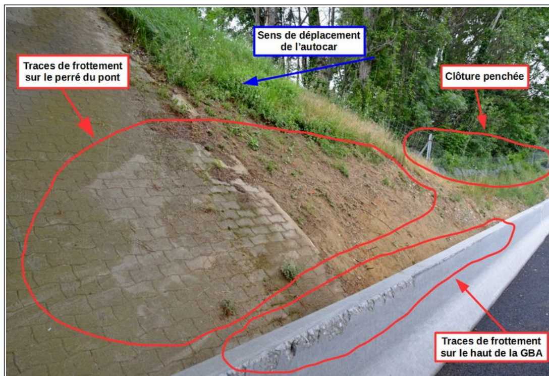
Figure 17 : Traces de l'accident au niveau du perré du pont
