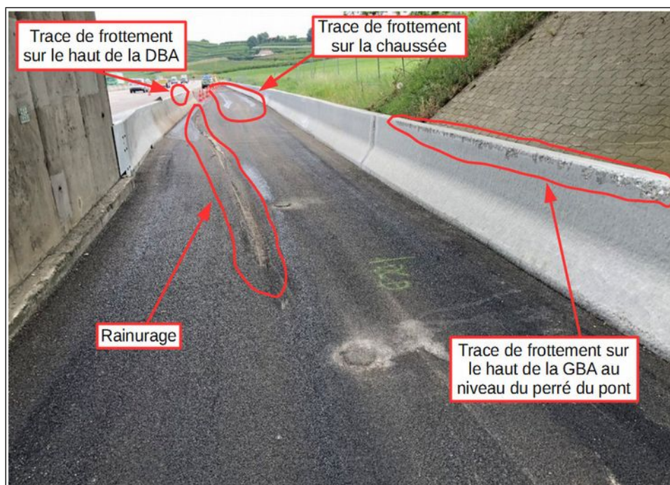
Figure 18 : Traces de l'accident sous le pont
