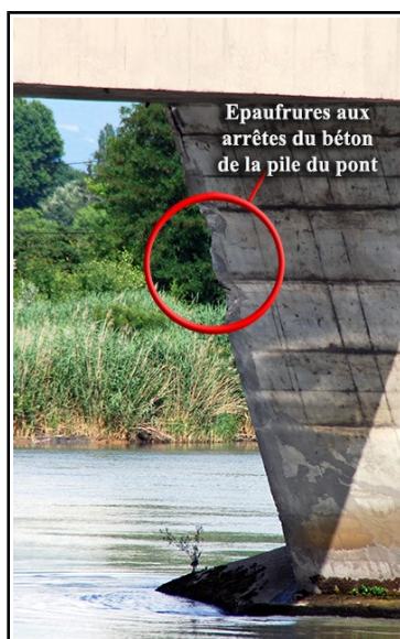
Figure 17 : Épaufrures aux arêtes en béton de la pile du pont SNCF de La Voulte-sur-Rhône
