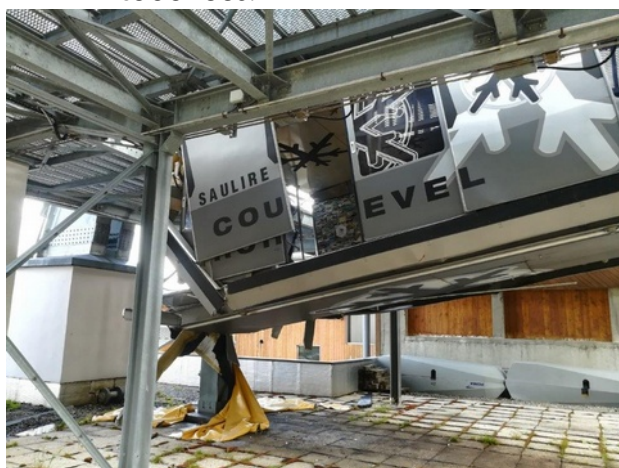
Cabine 1, gare aval
