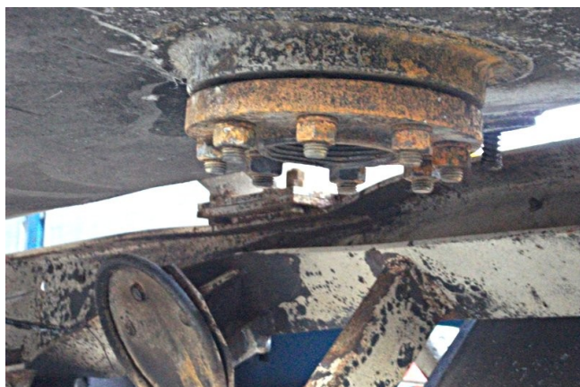
Figure 22 : Sortie de la phase liquide après l'accident
