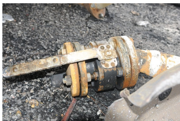
Figure 24 : Vanne de service de la phase liquide après l'accident
