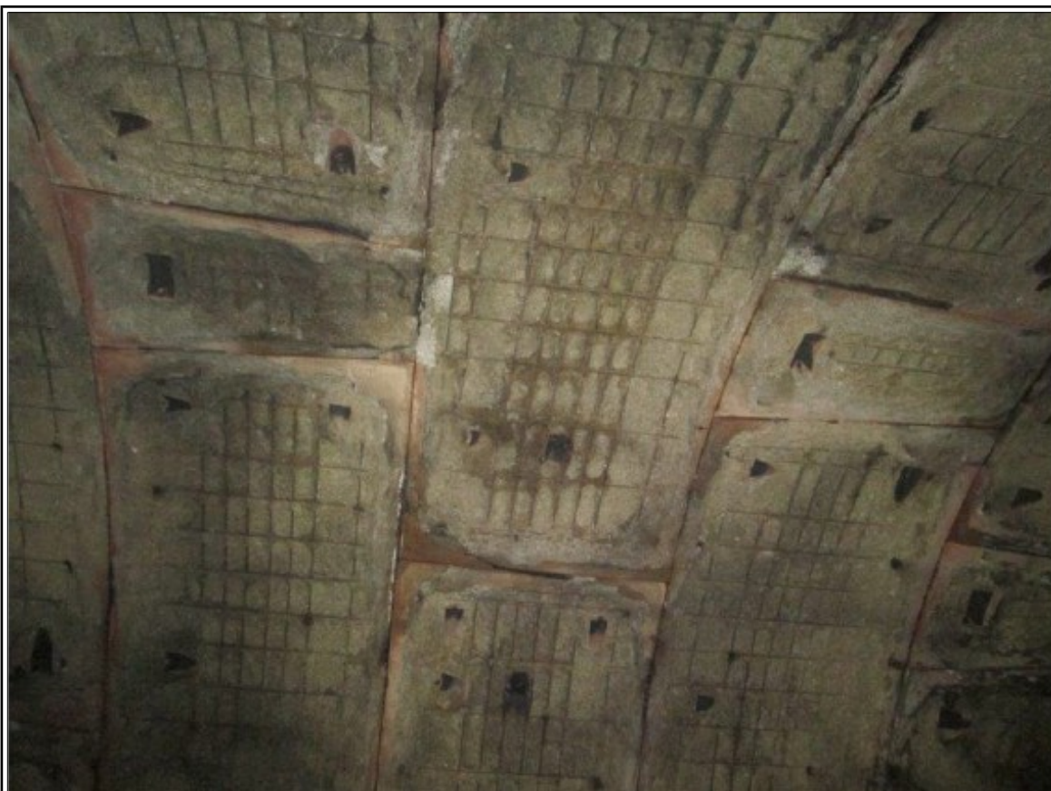
Figure 3 : Dégâts à la voûte du tunnel au droit des camions incendiés
