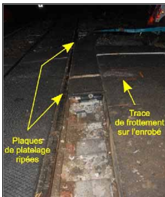
Figure 40 : Vue des plaques de platelage ripées et de la trace de frottement sur l'enrobé
