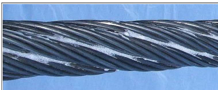
Fig. 14 : Le câble de la télécabine des Bosses avec ses torons
