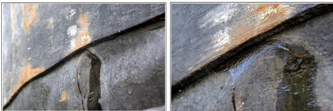
Figure 9 : À sec, une fuite était visible au niveau du puits aux chaînes de l'EOLE en dessous de son plan de flottaison chargé
