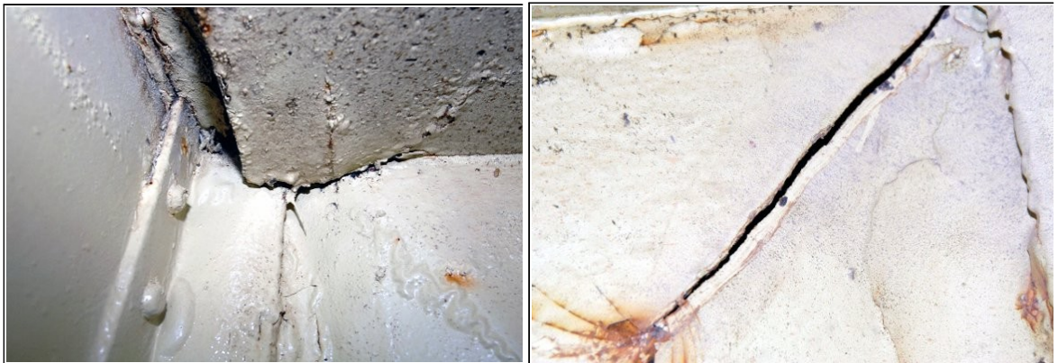
Figure 11 : Les fissures et déchirures constatées dans la cloison séparant les locaux techniques de la cale de l'EOLE
