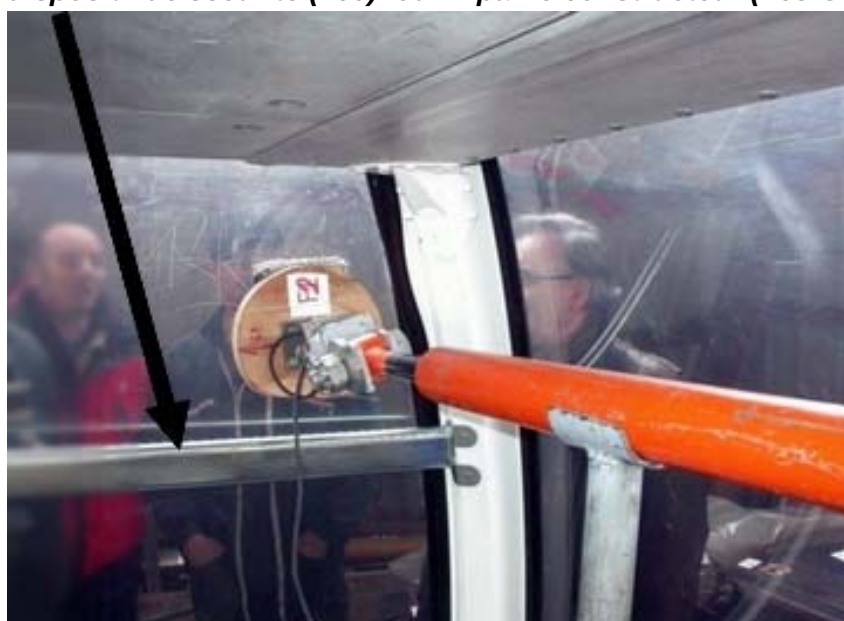
Photo 5 : Déboîtement d'un vitrage sur cabine « PICCOLO » déjà équipée du dispositif de sécurité (lice) fourni par le constructeur (Les Gets)
