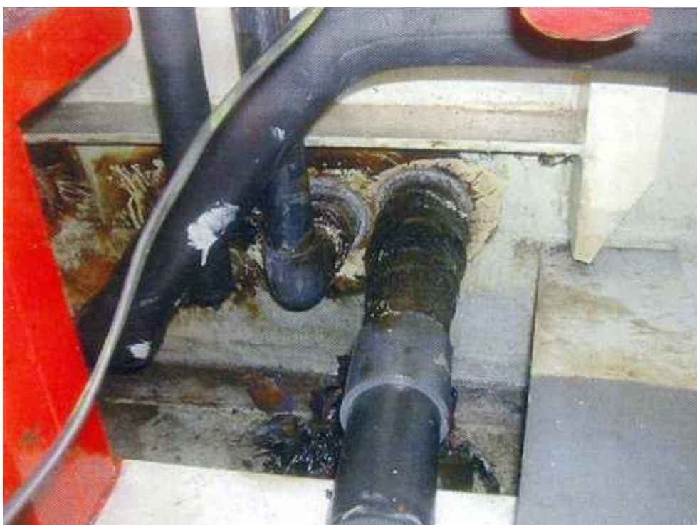
Traversées de cloison de tuyaux sanitaires non étanches
