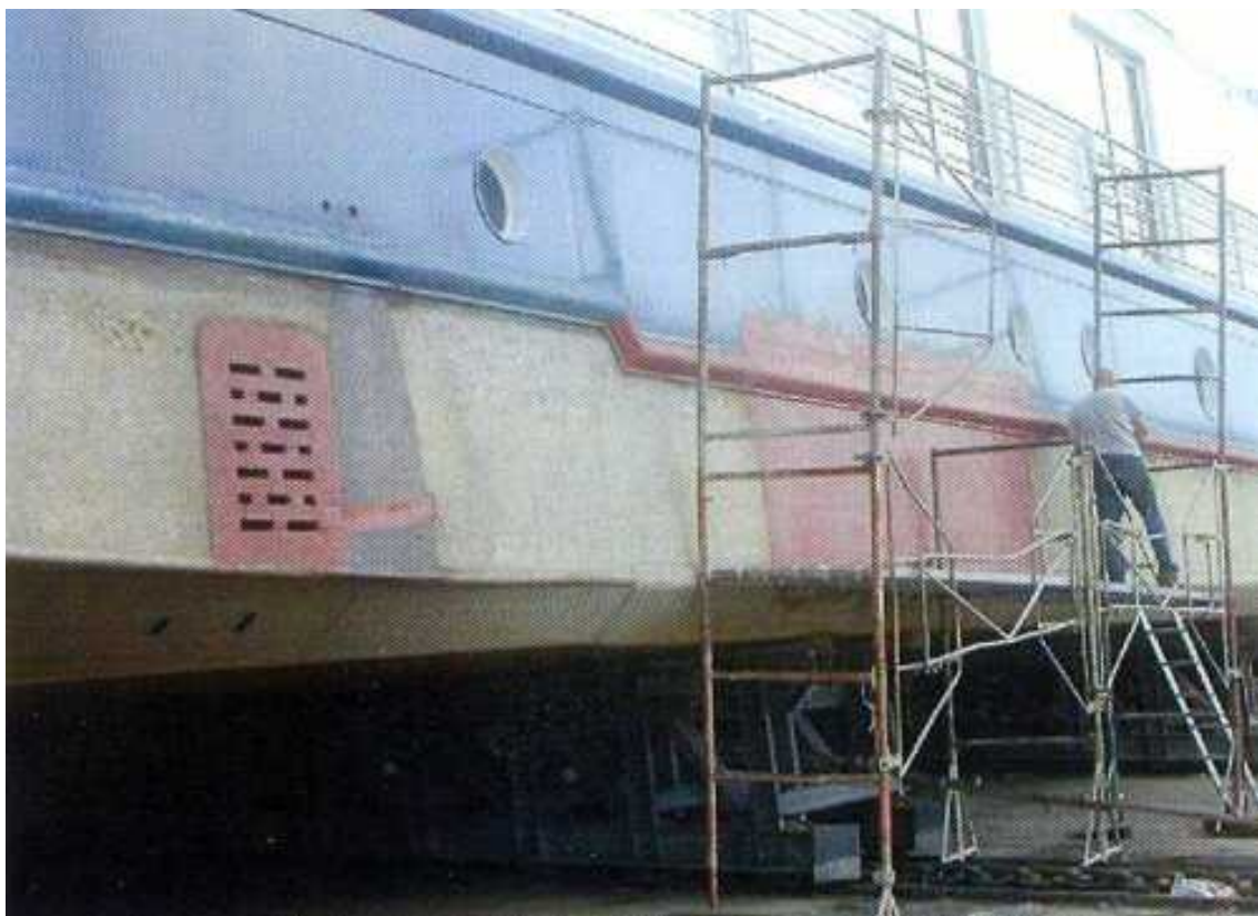
Brèche sur le bordé de muraille et sur le bouchain
