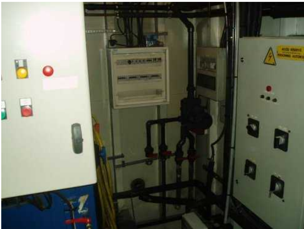
Pompe d'assèchement compartiment C4 dans le compartiment machine arrière bâbord
