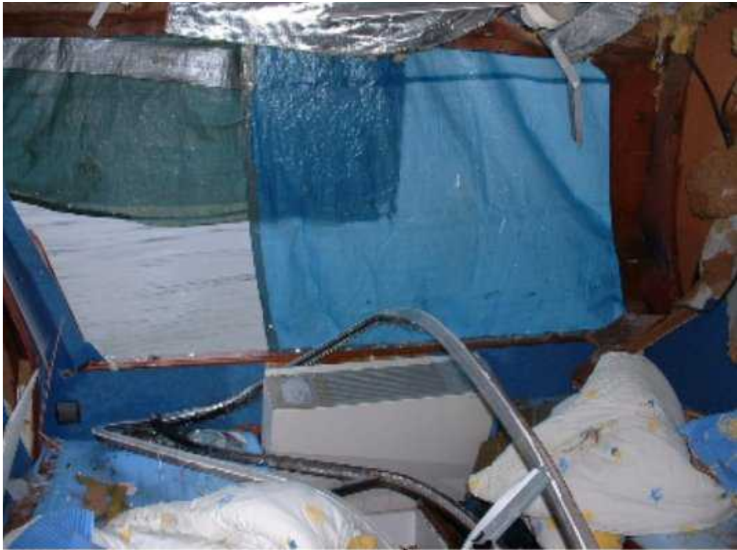
Dégâts à l'intérieur d'une cabine
