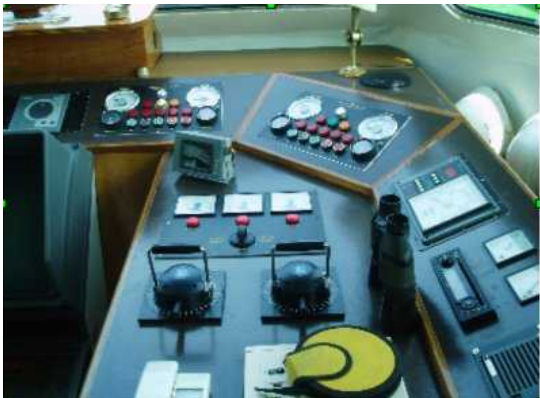
Combiné de commandes des propulseurs tribord et milieu et commande d'orientation des trois propulseurs
