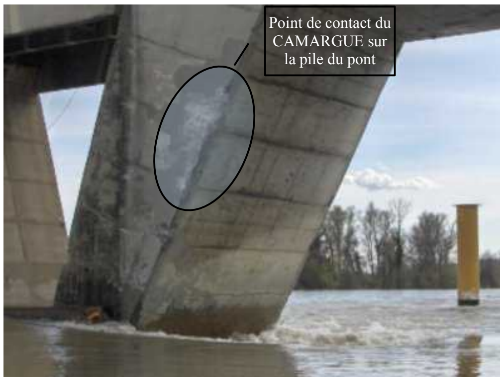
Pont de la Voulte épaufrure visible sur l'arête de la pile n°3 de la passe avalante
