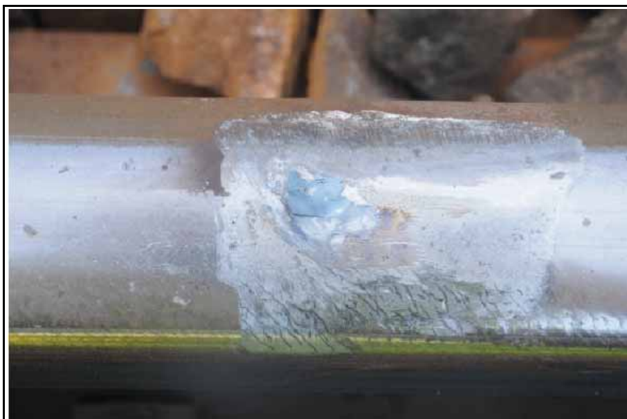
Figure 6 : Impacts sur le rail gauche voie 1
